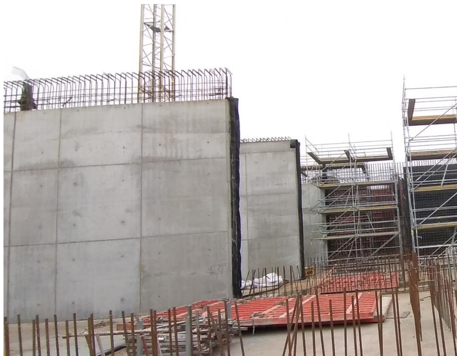
Foto 5: giunto strutturale nei setti risolto con doppio profilato WS RGF PVC 300 WS e WT PVC 320
