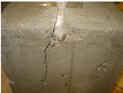
Fessura indotta non passante
